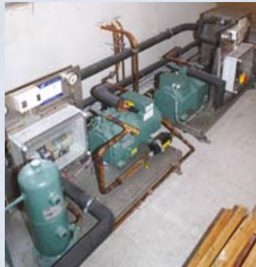
Die beiden Kompressoren wurden geschützt auf dem gut belüfteten Dachboden aufgebaut.
