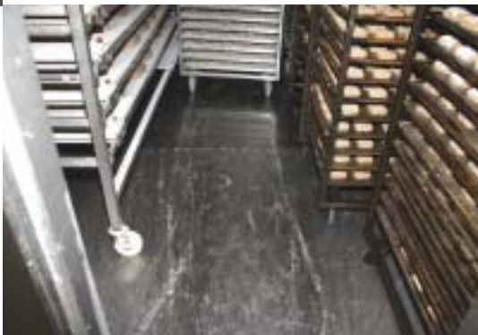
Der Boden ist zur einfachen Reinigung glattflächig. Die Bodenheizung sorgt dafür, dass kein Wasser im Gärunterbrecher steht.
